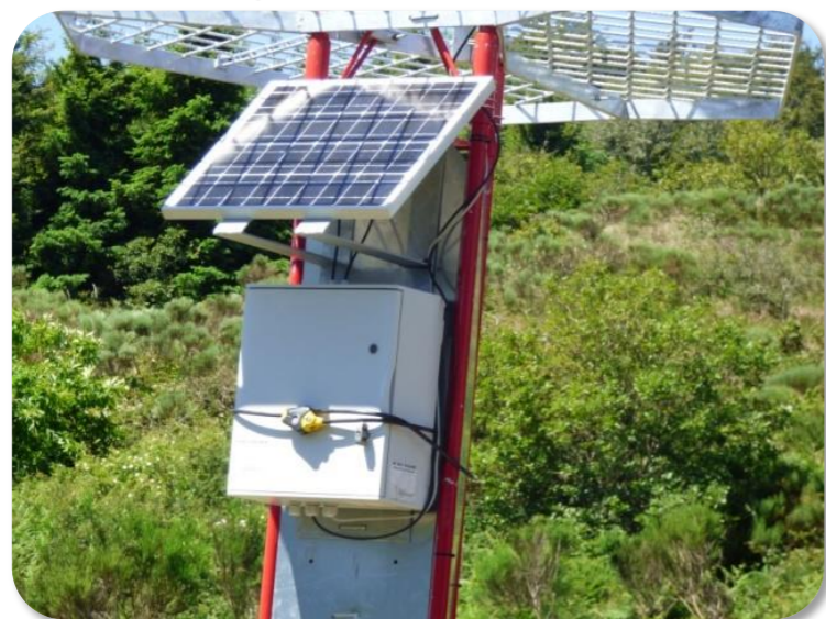
Photo 157 : Dispositif similaire installé sur mât de mesure
